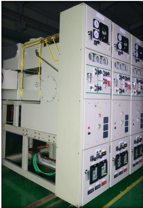
가스절연 개폐장치 (GIS) 25.8kV, 630/2000 A 25kA, 60Hz
